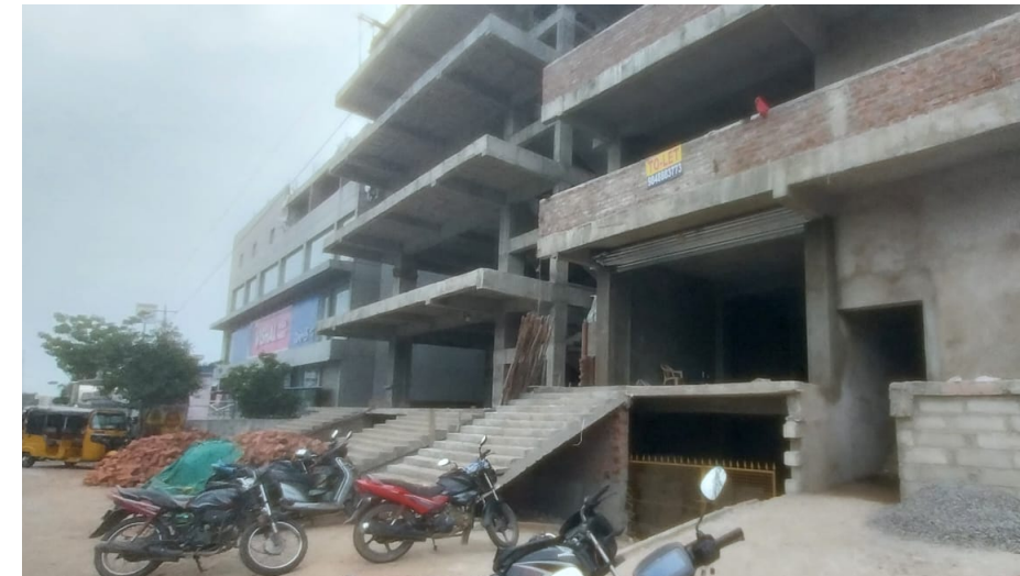
టైపాన్ లో రోడ్డు ఆక్రమించి నిర్మాణం
